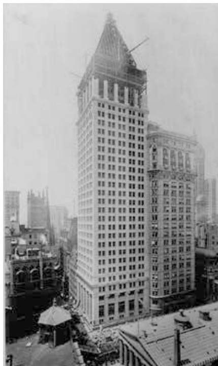
Gebäude der Bankers Trust Co. im Bau, New York, 20.6.1911. (Foto: Irving Underhill, picryl.com, Gemeinfrei)
