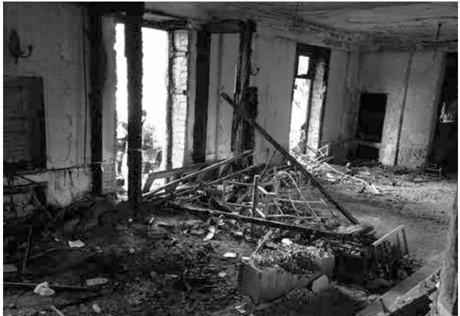
Blick in das abgebrannte Gewerkschaftshaus in Odessa. (Foto: Lsimon, CC BY-SA 4.0)
